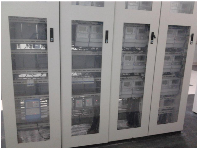
集中器，采集器也安装在电表箱内
